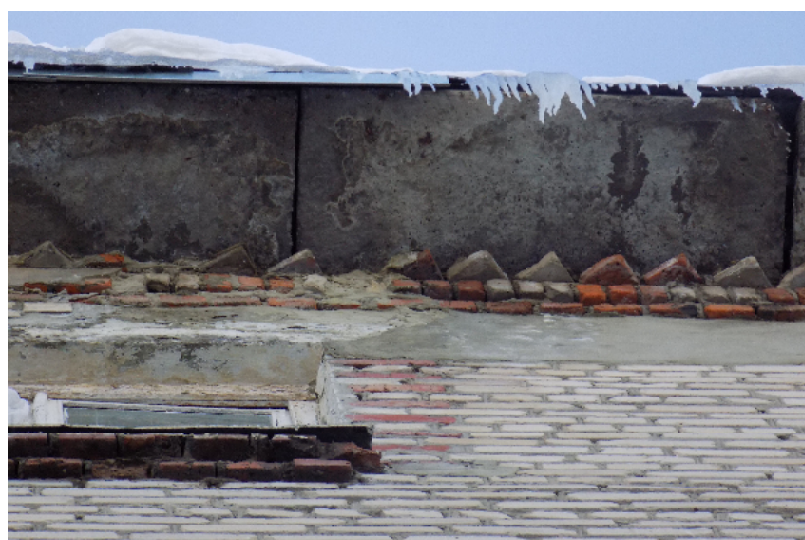
«Плюющаяся» кирпичами крыша: вид снизу
