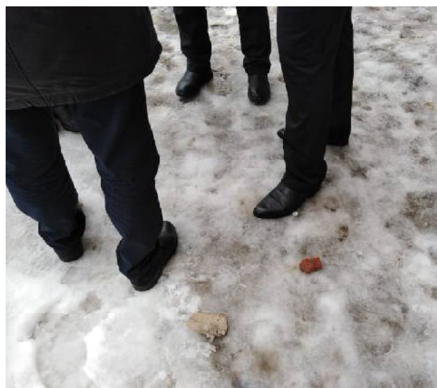
Приезжие начальники обсуждали, есть ли повод вводить режим ЧС. А у их ног лежали обломки кирпичей, выпавших из-под крыши пятиэтажки
